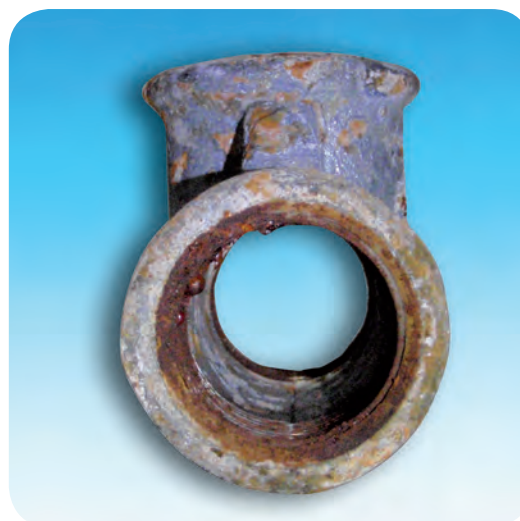
ESEMPI DI INQUINAMENTO DI IMPIANTO (RUGGINE) EXAMPLES OF SYSTEM POLLUTION (RUST)
