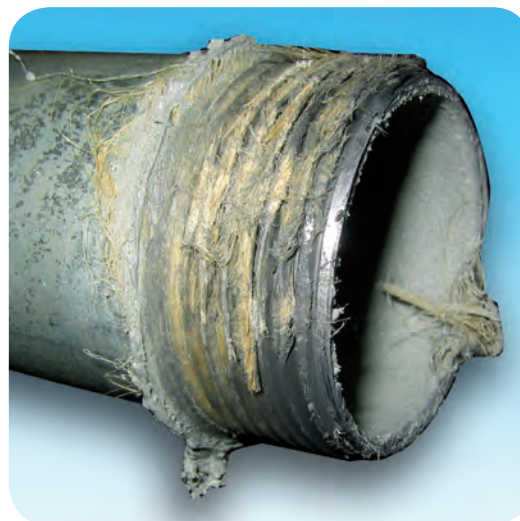
ESEMPI DI INQUINAMENTO DI IMPIANTO (PASTA E CANAPA) EXAMPLES OF SYSTEM POLLUTION (PASTE AND HEMP)
